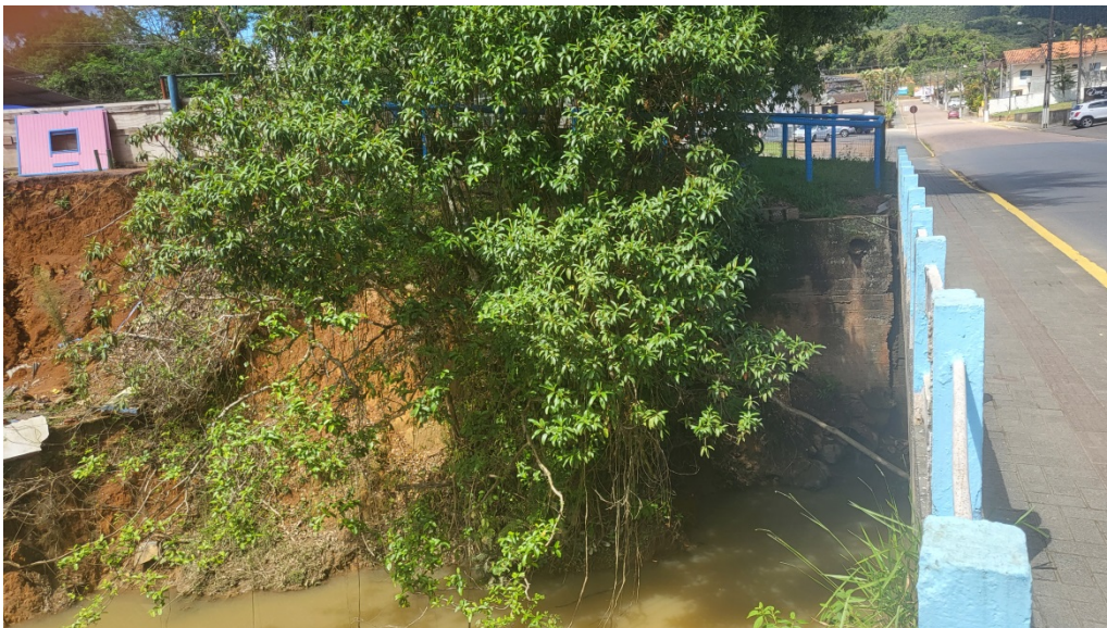
Foto 02 – Talude de margem colapsado – encontro com cabeceira de ponte existente na rua Dom Bosco.
