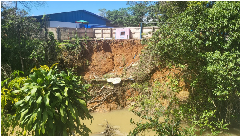
Foto 06 – Talude de margem colapsado – imagem ampla, com tapume de proteção no pátio da creche.
