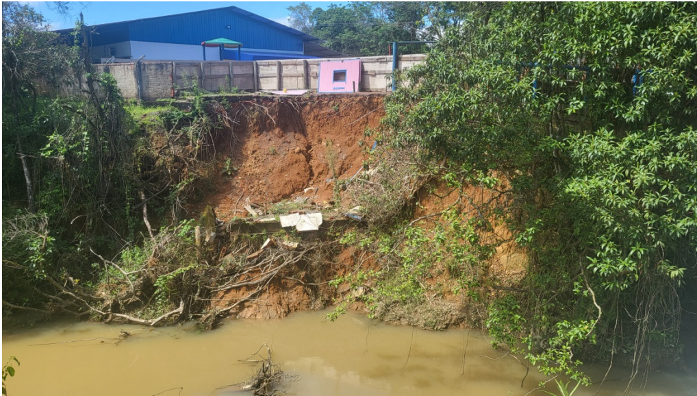
Foto 01 – Talude de margem colapsado – imagem frontal
