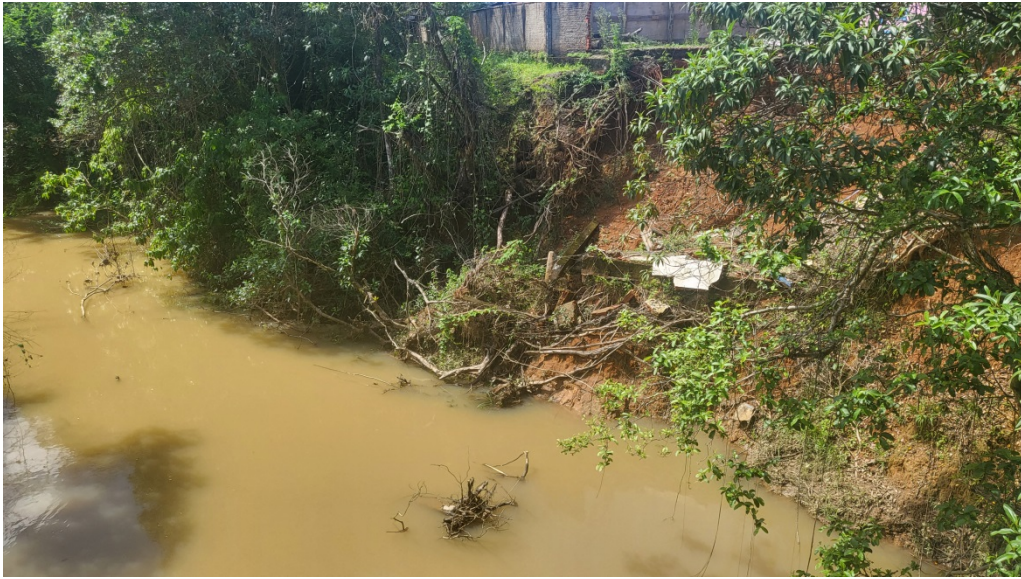
Foto 03 – Talude de margem colapsado – imagem “pé” da margem do talude, Nível da água
