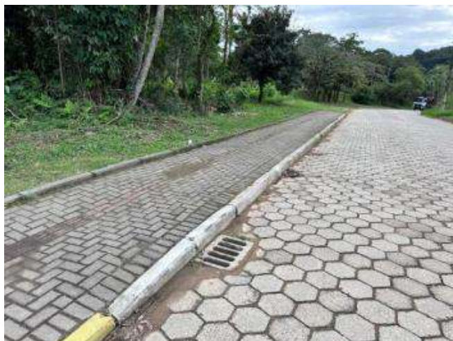
Imagem 18: Sistema de drenagem de águas pluviais na rua Indaial próximo ao acesso ao empreendimento.
